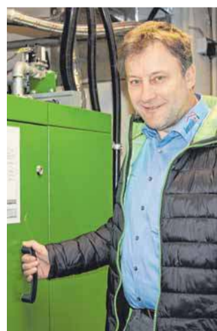
Gerd Pieper stellt sein modernes Blockheizkraftwerk vor.
