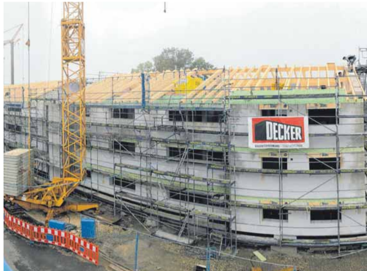
Die spätere Form des Gebäudes lässt sich schon erkennen, doch noch steht noch viel Arbeit aus. Ohne Dach lässt es sich schlecht wohnen. FOTO: PM
