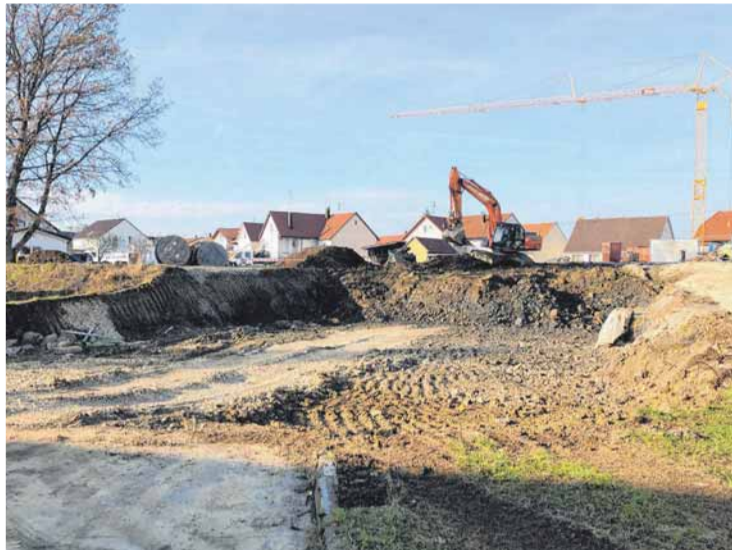
Am Anfang ist noch nicht viel zu erkennen, die meisten Arbeiten finden noch unter der Erde statt. Foto: PM
