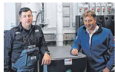
Christian Zisterer vom Autohaus Zisterer und Gerd Pieper, Paul Hermle GmbH vor der neuen Heizungsanlage. FOTO: HERMLE
